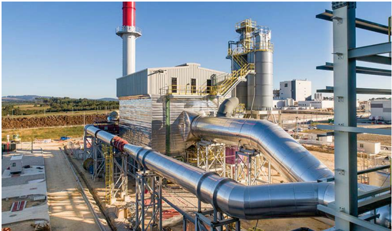
PLANTA DE BIOMASA CURTIS 50MW
